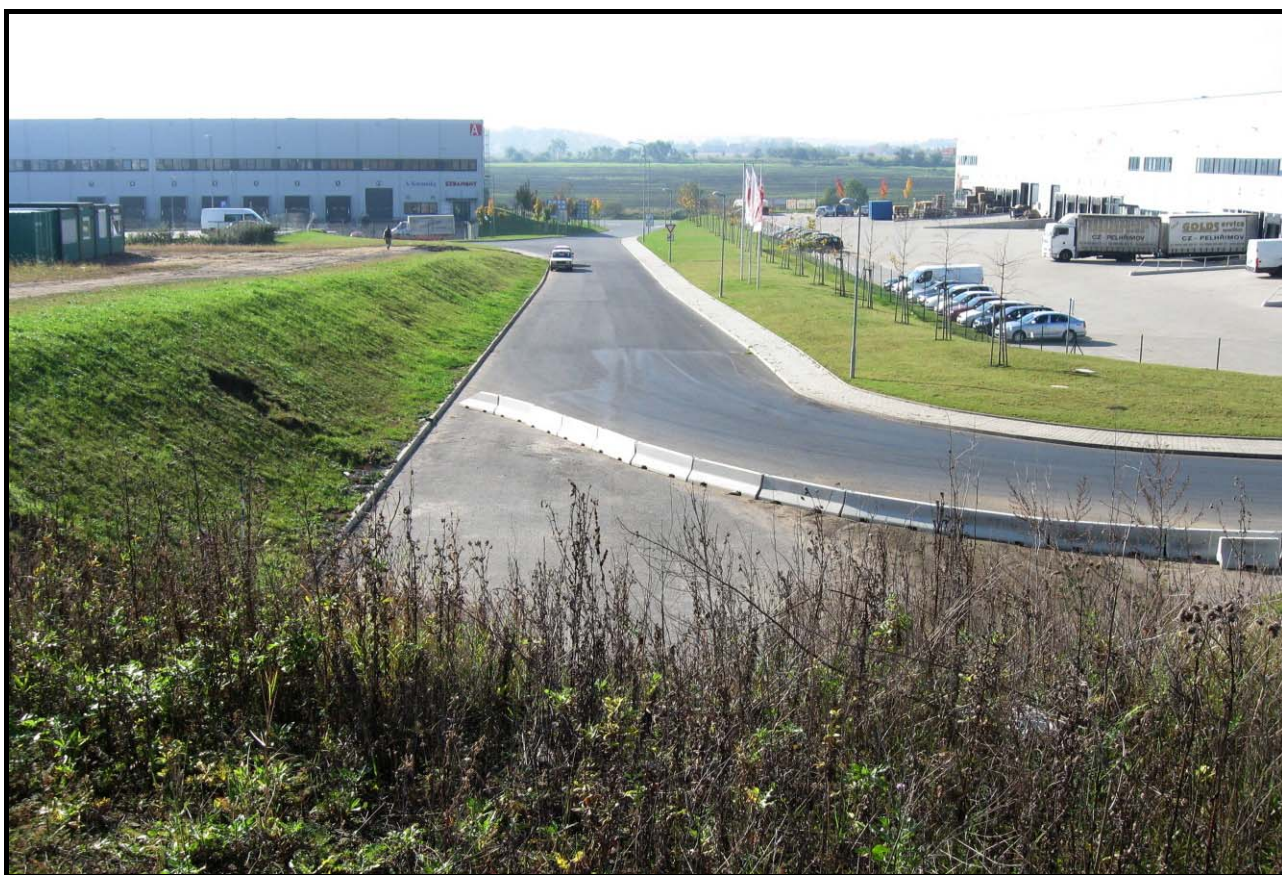
Ulice od severu 8. října 2010. Betonová svodidla ohraničují slepý úsek budoucího prodloužení pod železniční trať
